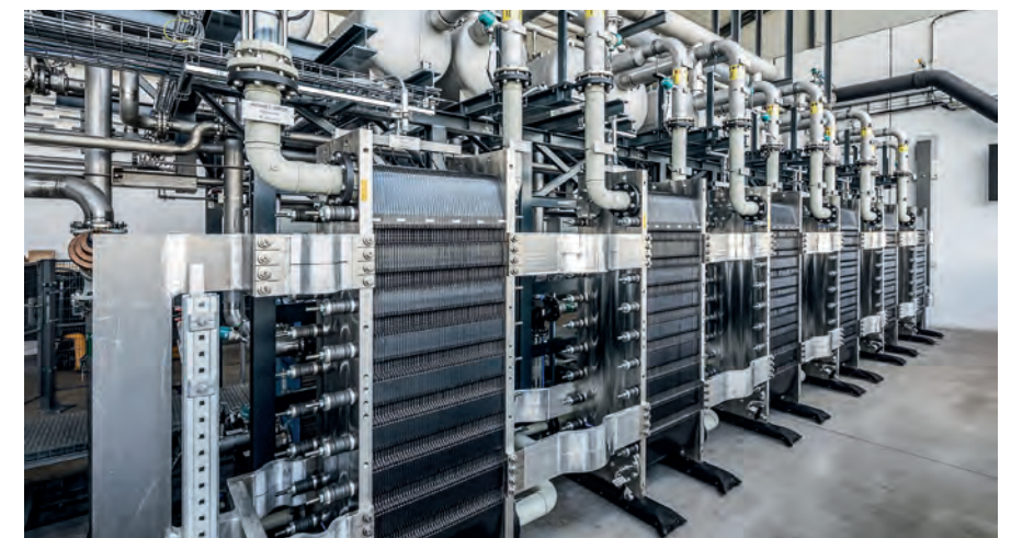
Die Wasserstoffpilotanlage am Standort Linz ist zukunftsweisend.
